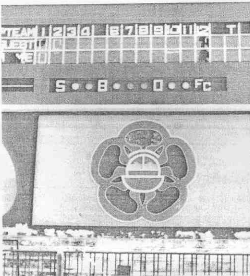
台南市立棒球場電動計分牆不實用，有不少破損。
