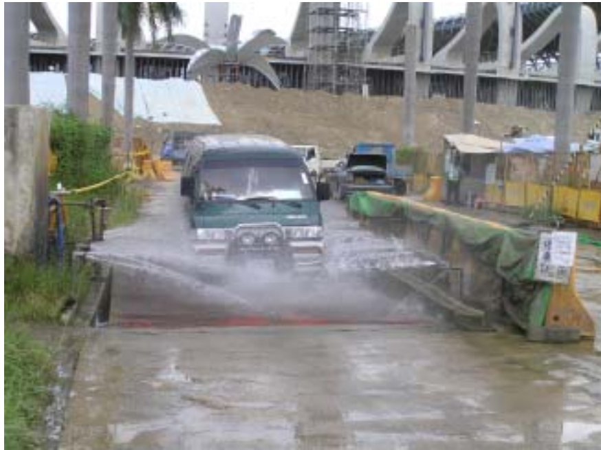
圖 4-8：工地出口裝設清洗車輛設備（相片來源：研究者）。
