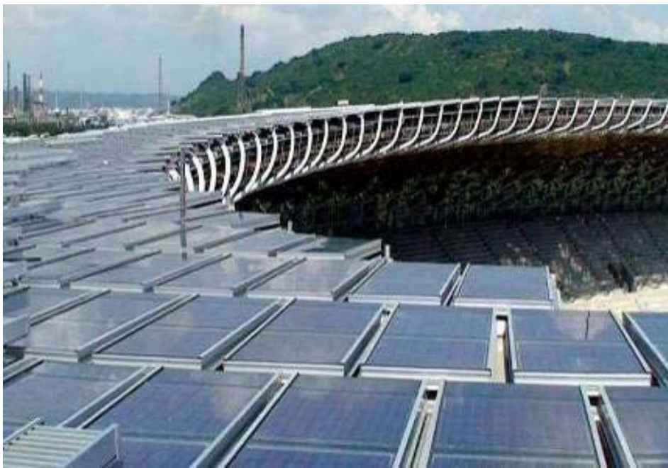
圖 3-5：主場館屋頂結合太陽能板設計（相片來源：互助營造股份有限公司）。
