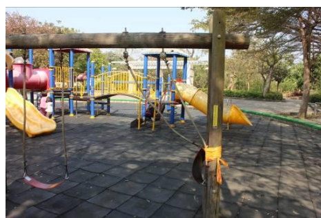
兒童遊戲區數處待修的盪鞦 鞦
